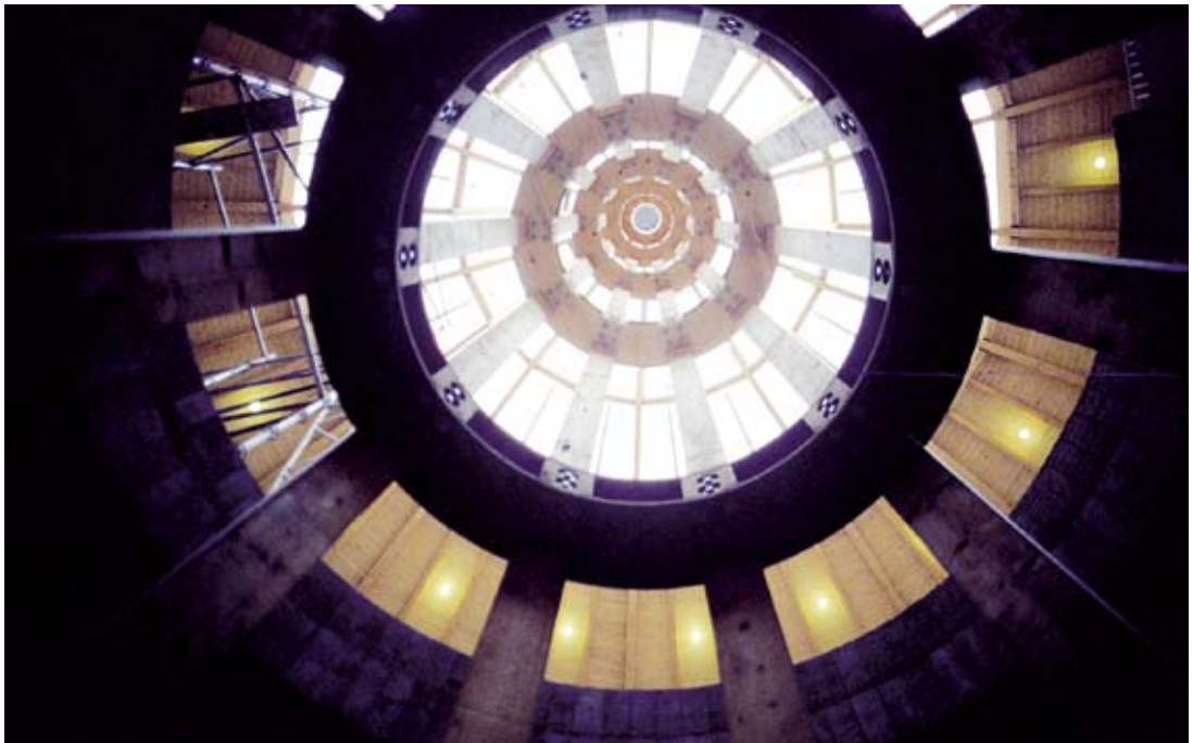
4 Das Lüftungskonzept der Freien Waldorfschule Köln mit sternförmig angelegten Lüftungskanälen: Kellergeschoss (oben), Betonrohre (90 cm Durchmesser) als Zuluftkanäle (Mitte), Blick aus dem Keller ins Innere der 15 m hohen Baumstütze, die aus zehn filigranen Einzelhölzern besteht und als Luftverteilungselement dient.
